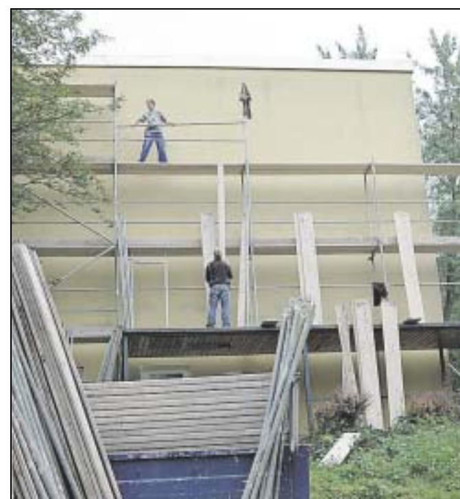
Die Baugerüste stehen schon: Die Turnhalle der Regenbogenschule wird renoviert. Foto: Sebastian Grote
